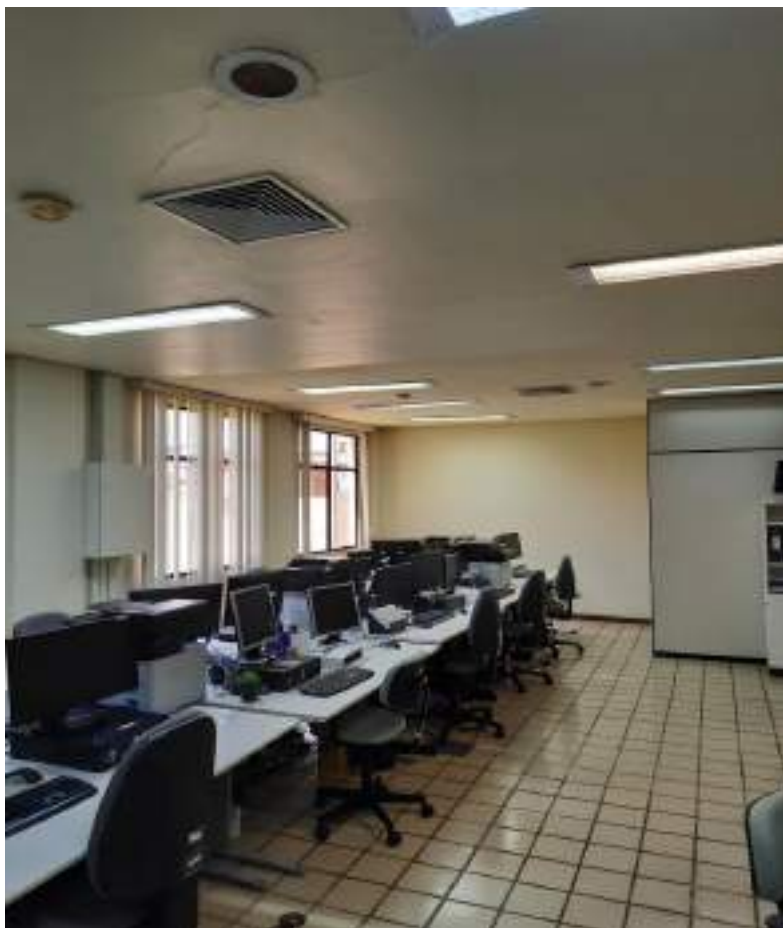
Foto 5.2.1.3 – Difusores no forro de gesso na central de mandados
