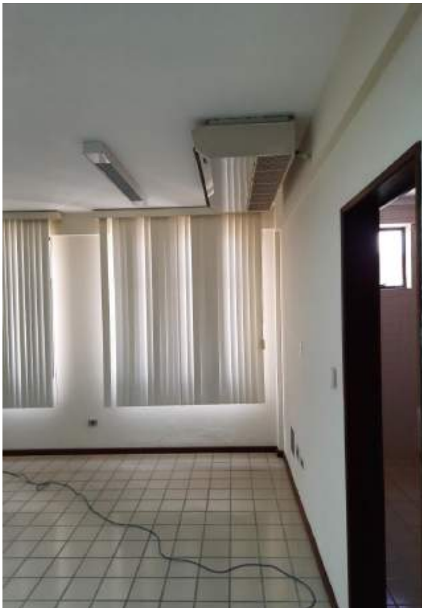
Foto 5.2.1.6 – Equipamento Existente – Piso Teto instalado no 3º Pav. Ed. Sede
