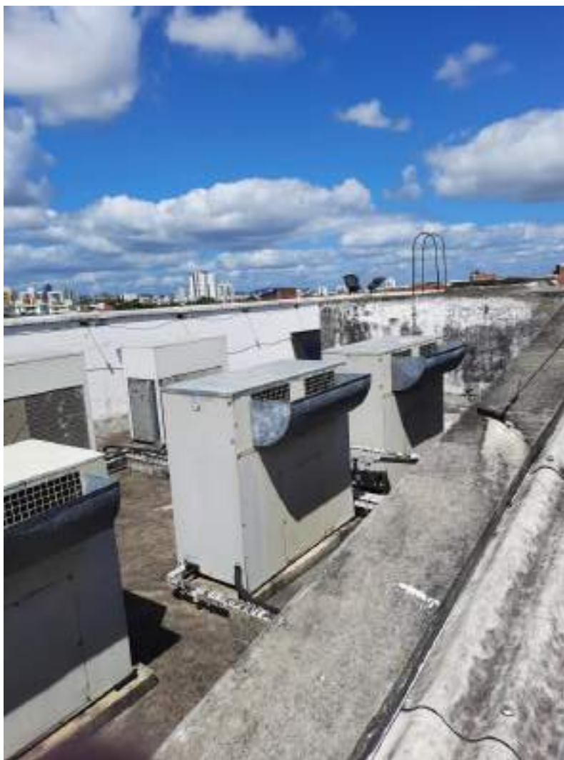
Foto 5.2.1.13 – Condensadoras Edifício Anexo I.
