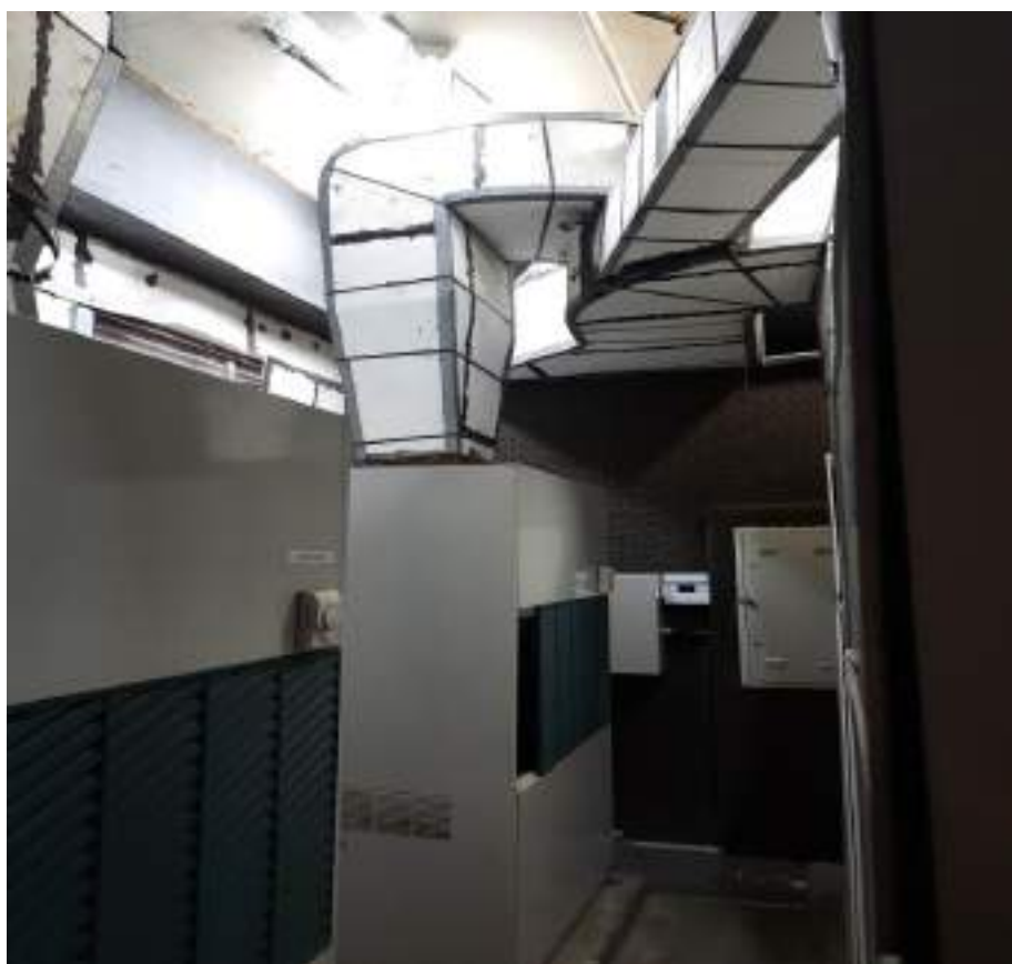
Foto 5.2.1.1 – Casa de Máquinas Ed. Sede - Térreo
