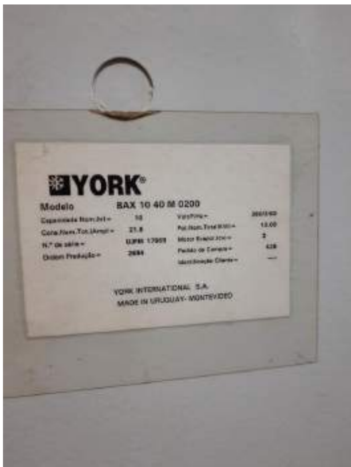
Foto 5.2.1.1 – Especificação Evaporadora York
