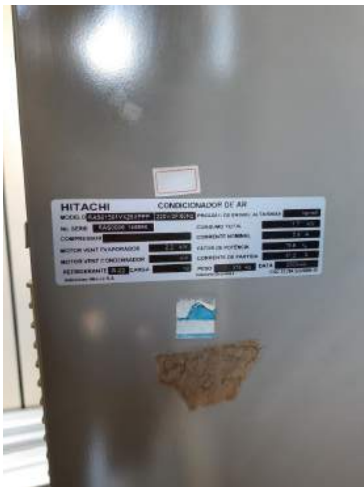
Foto 5.2.1.12 – Especificação Evaporadora Edifício Anexo I.
