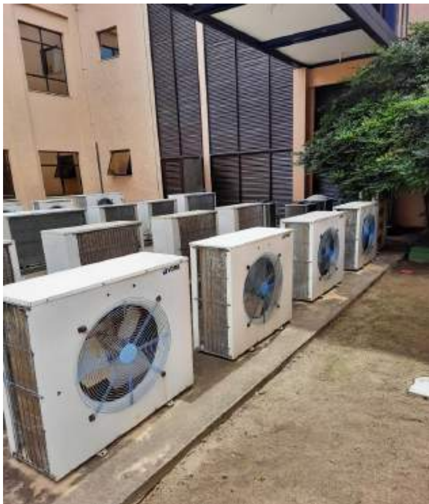
Foto 5.2.1.5 – Patio das Condensadoras
