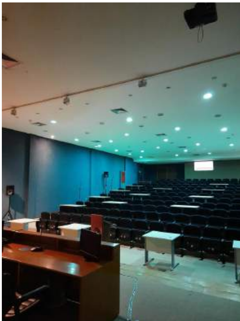
Foto 5.2.1.8 – Auditório Anexo I – Detalhe dos difusores instalados no forro.
