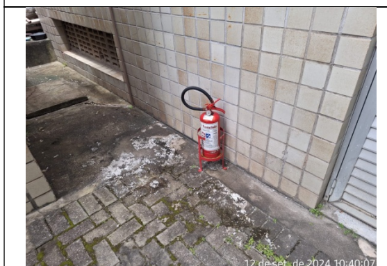
VERIFICAÇÃO DO NÚMERO DE EXTINTORES DISPONÍVEIS
