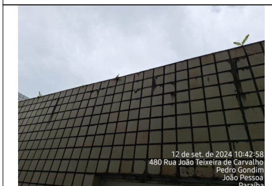
SUGERE-SE UMA LIMPEZA DA COBERTA DA SALA DO GERADOR
