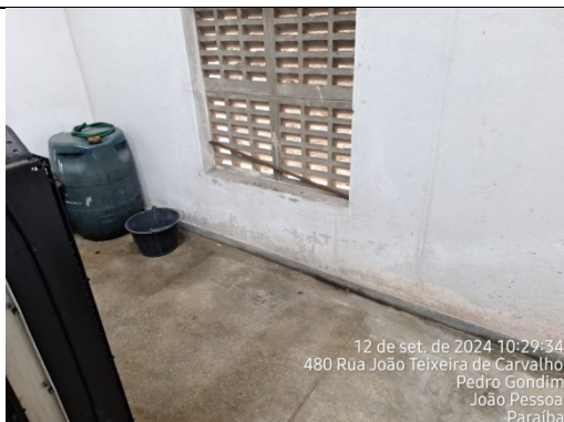
SUGERE-SE INSTALAÇÃO DE TELA DE PROTEÇÃO CONTRA ANIMAIS E INSETOS
