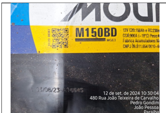
REGISTRO DA DATA DE FABRICAÇÃO DA BATERIA DO MOTOR GERADOR
