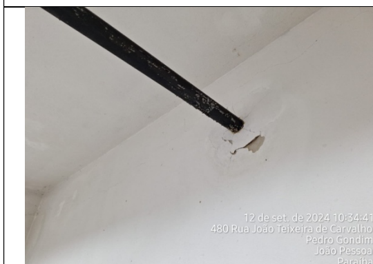
REGISTRO DA NECESSIDADE DE REBOCO E PINTURA
