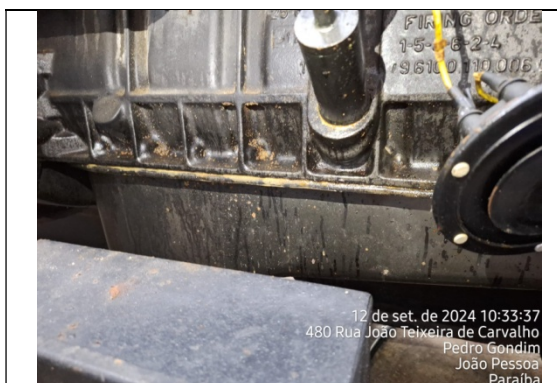
REGISTRO DE VAZAMENTO DE ÓLEO DO MOTOR PELAS JUNÇÕES
