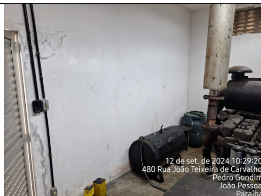
SITUAÇÃO ATUAL DO TANQUE DE COMBUSTÍVEL. INDICA-SE TROCA DO MESMO
