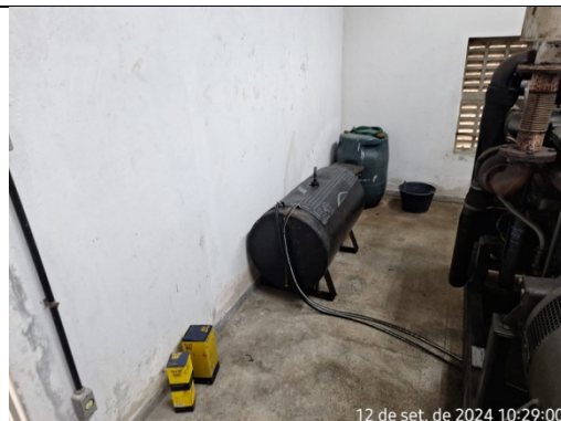
INDICAÇÃO DA TROCA DO TANQUE DE COMBUSTÍVEL
