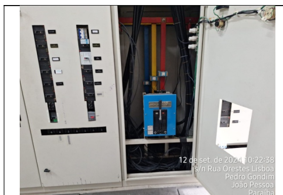
REVER A TROCA OU DESATIVAÇÃO DO DISJUNTOR INATIVO
