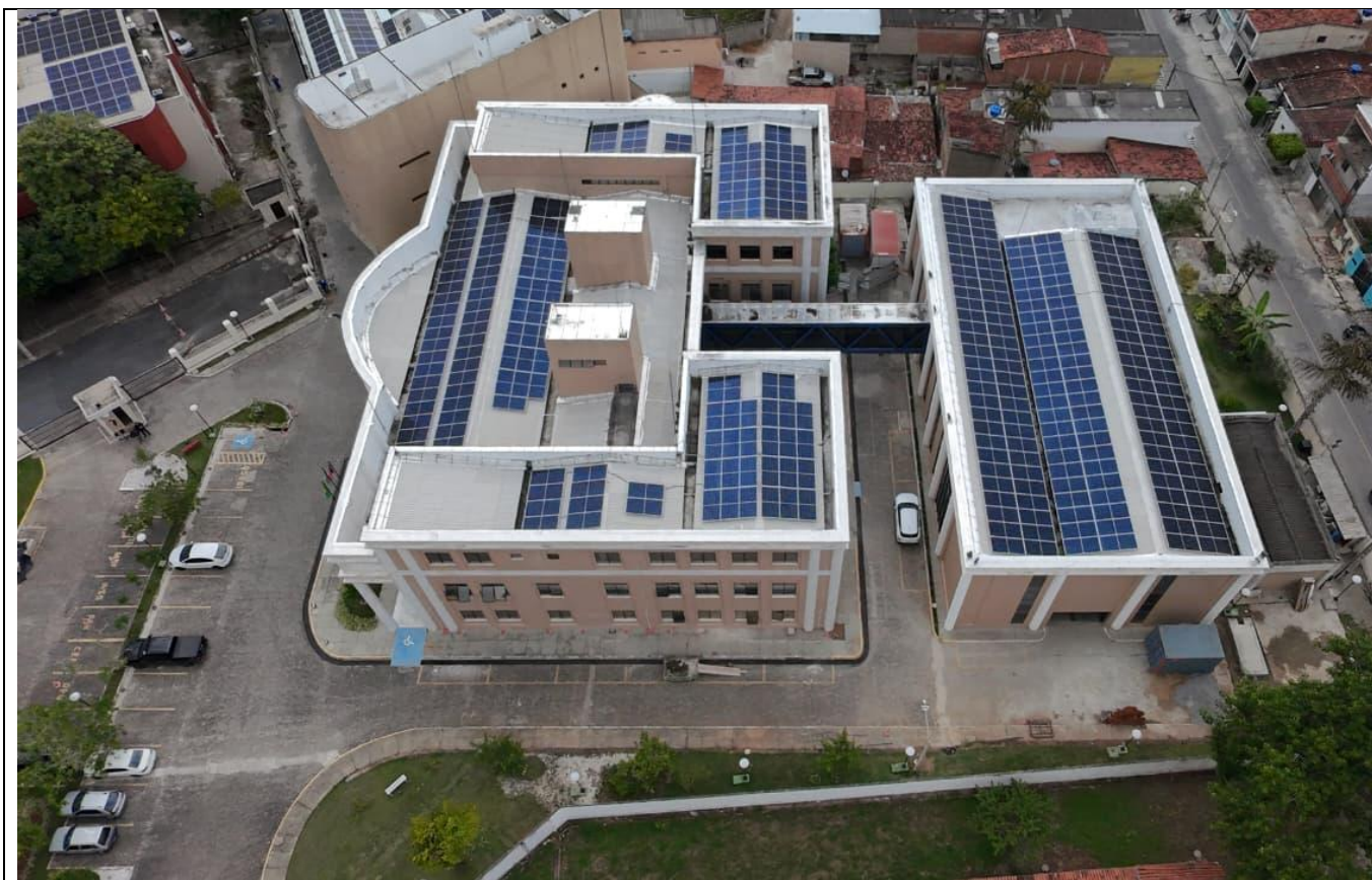
FOTO 02: Foto da situação atual da usina fotovoltaica do edifício sede e Anexo I da Subseção Judiciária de Campina Grande
