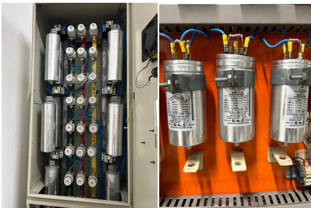
figura 8 - Quadros de Banco de Capacitores
