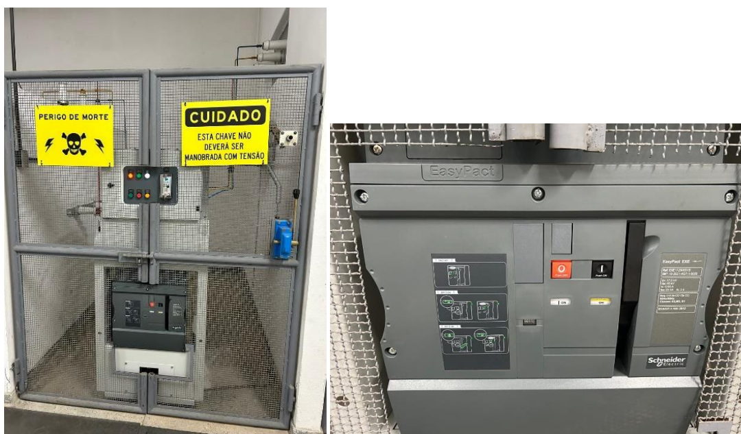
Figura 3 – Disjuntor de Média Tensão
