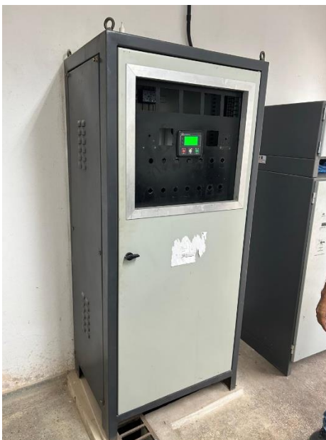
figura 11 – QTA – Quadro de Transferência Automática / USCA
