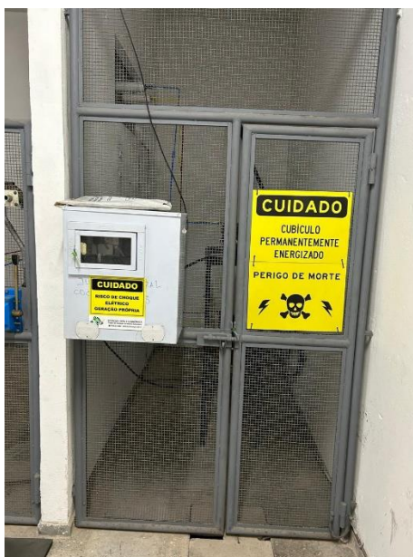
Figura 6 – Cubículo de Entrada em Média Tensão – Medição Energisa
