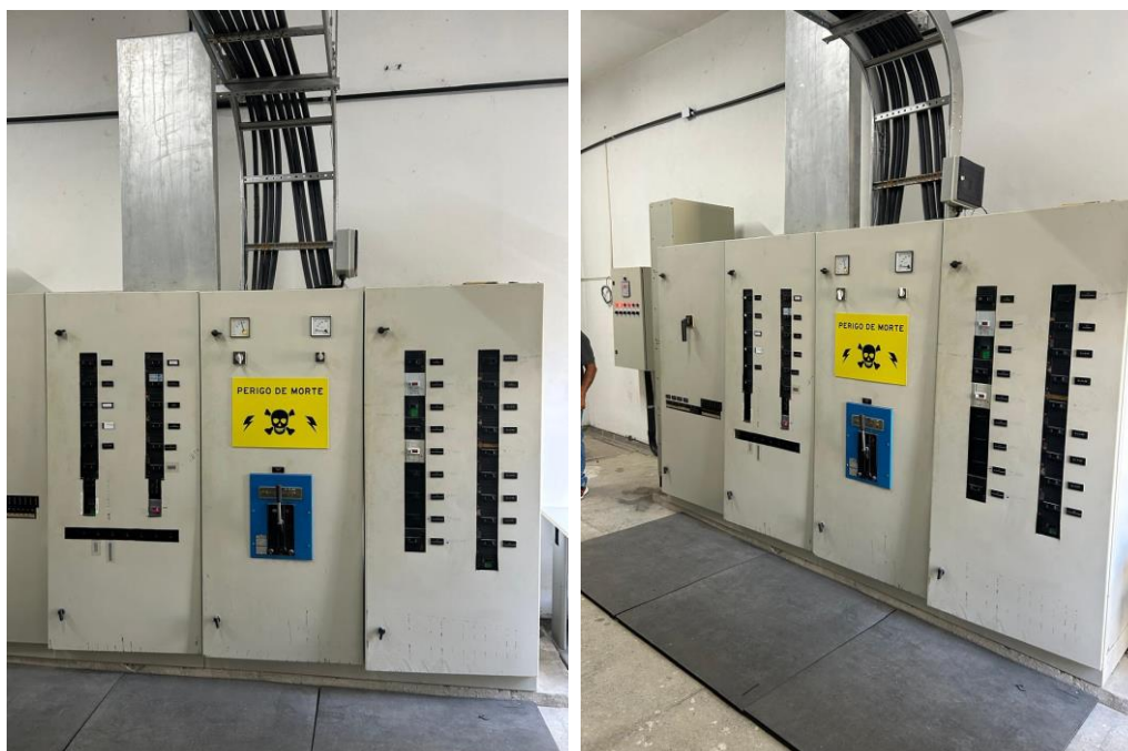
figura 7 – QGBT – Quadro Geral de Baixa Tensão
