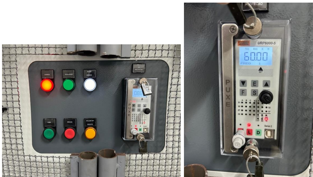
Figura 4 – Relé de Proteção Secundária
