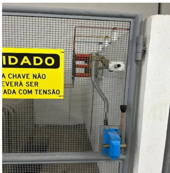
Figura 2 – Chave Seccionadora de 15kV
