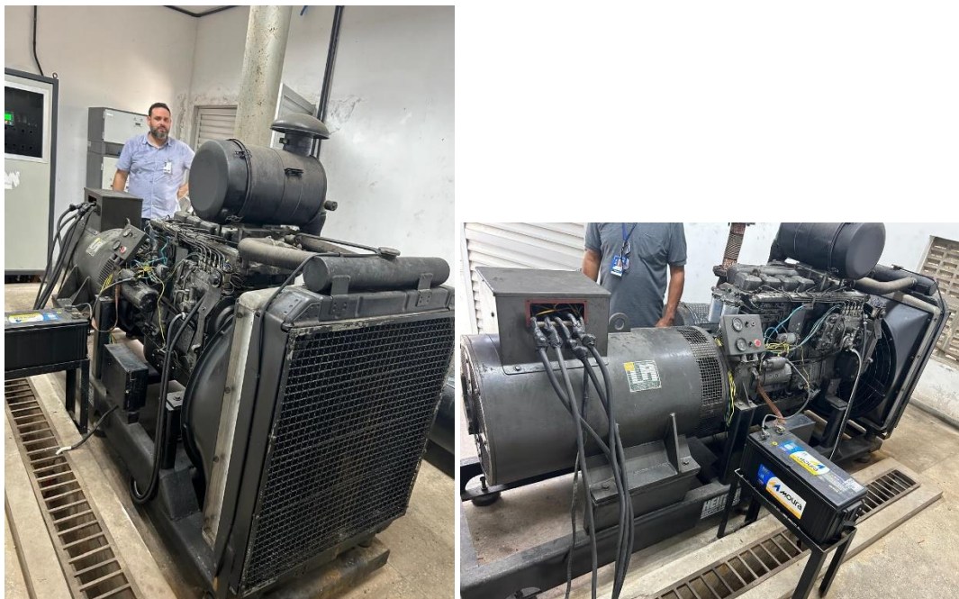
figura 9 – Grupo Motor Gerador
