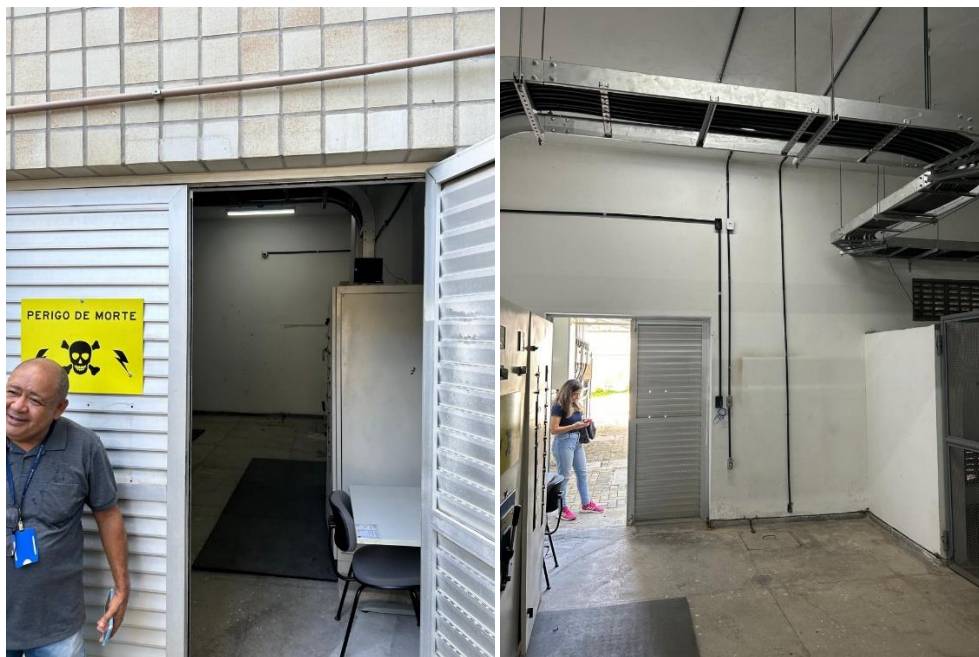
figura 5 – Vista Externa e Interna da Subestação
